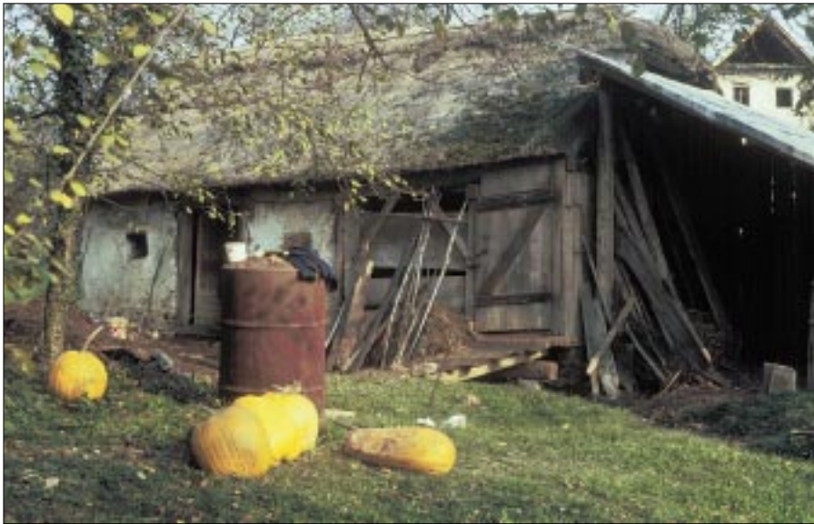
Objekti s tradicionalno slamnato kritino so dokaj redki, pa še ti navadno v propadajočem stanju. (M. T.)
